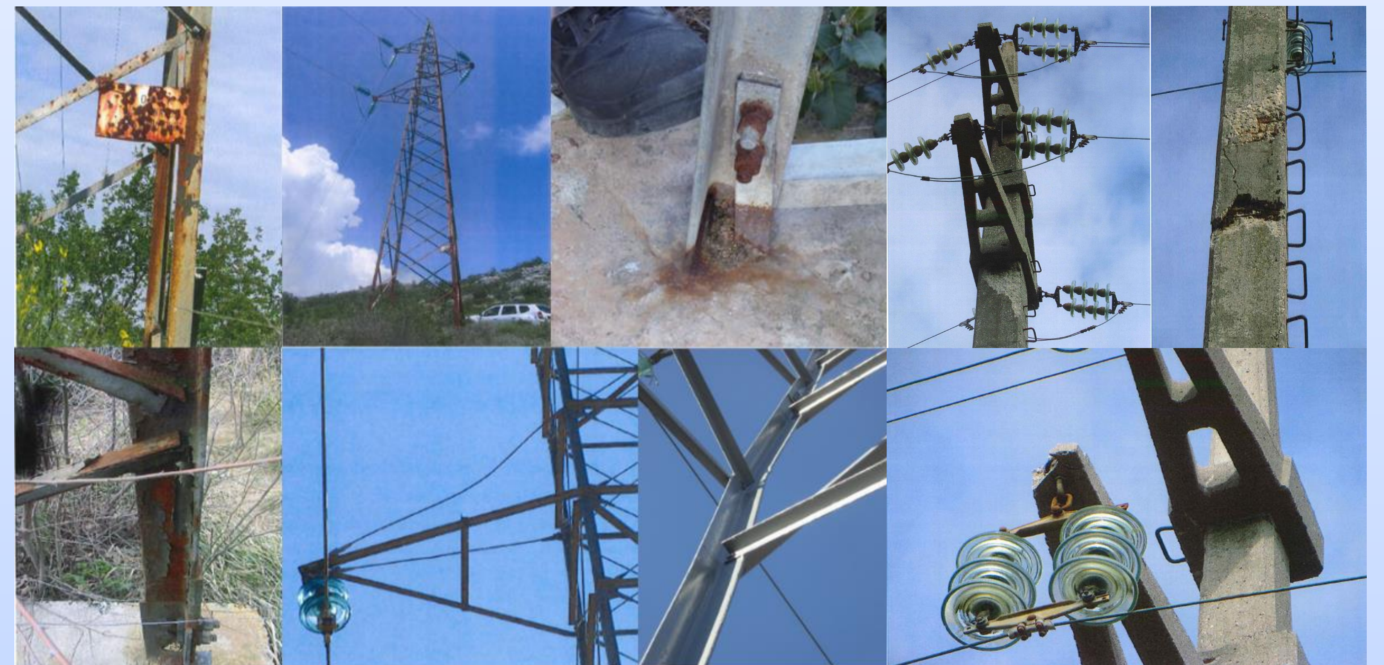
Slika 2 – Primjeri oštećenja stupova
